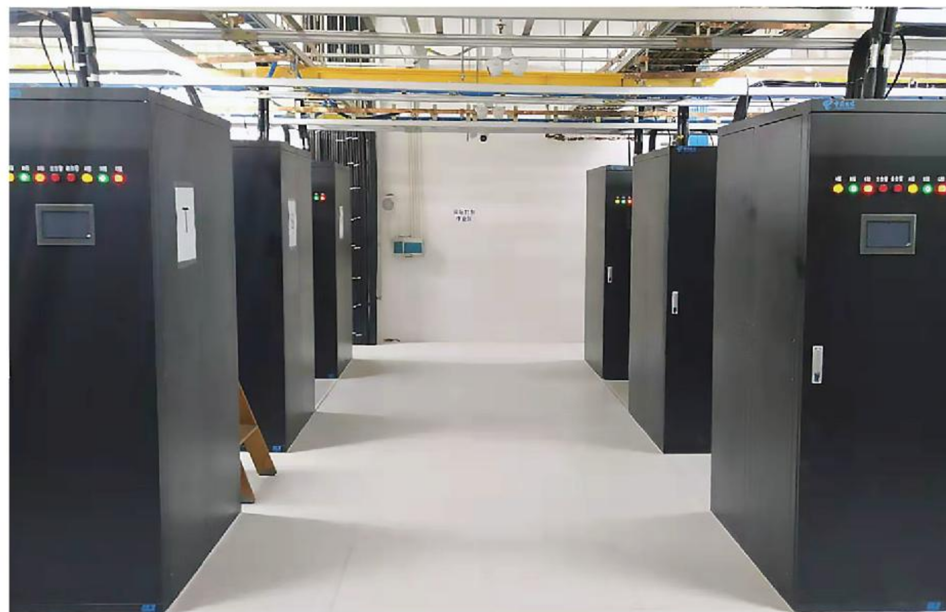
江西电信二厂楼核心网ITC机房
