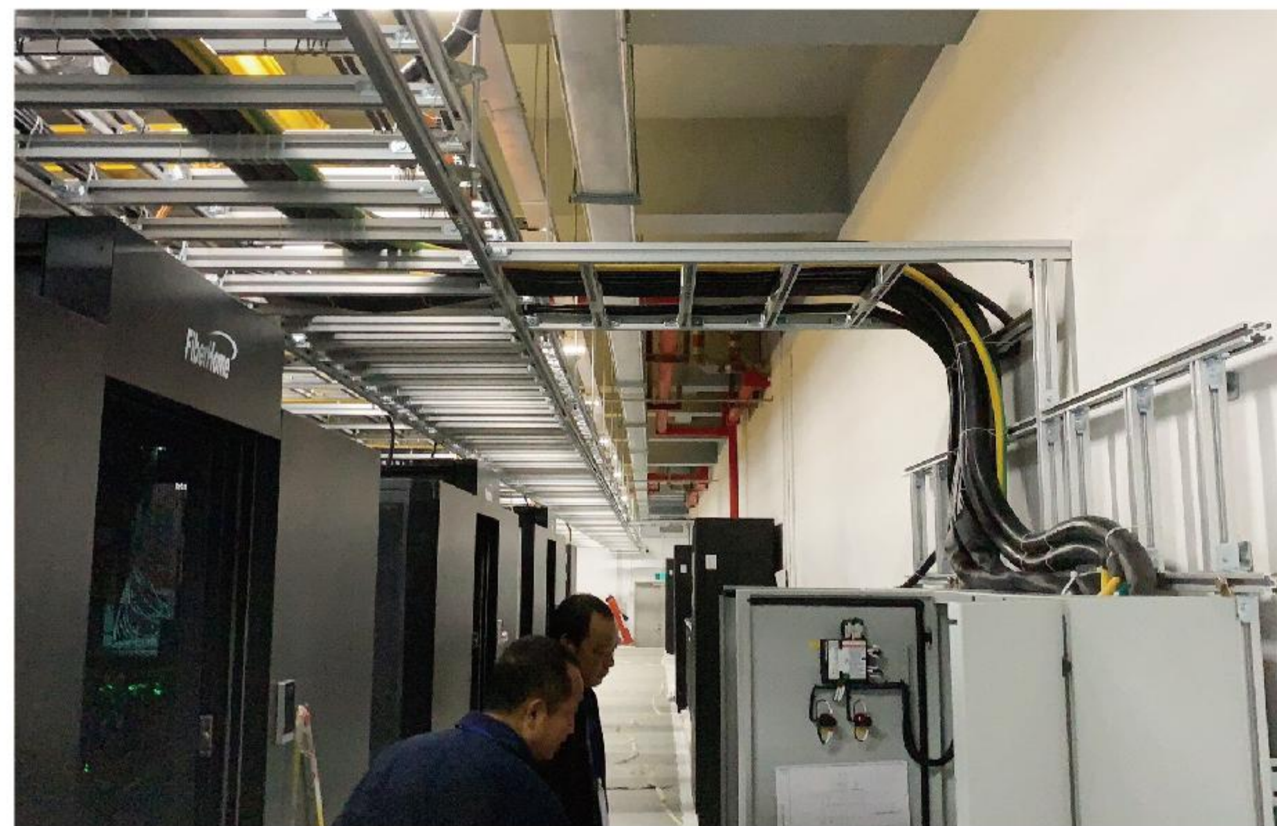
云南移动呈贡数据中心项目
