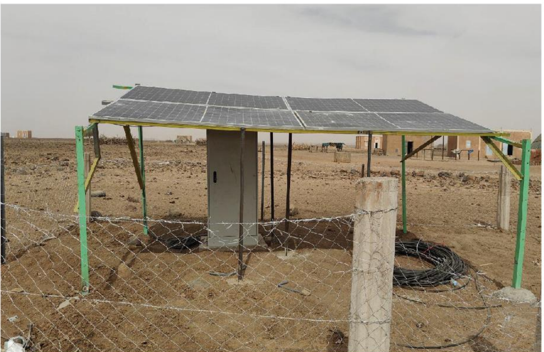
毛里塔尼亚 室外通信站点能源机柜
