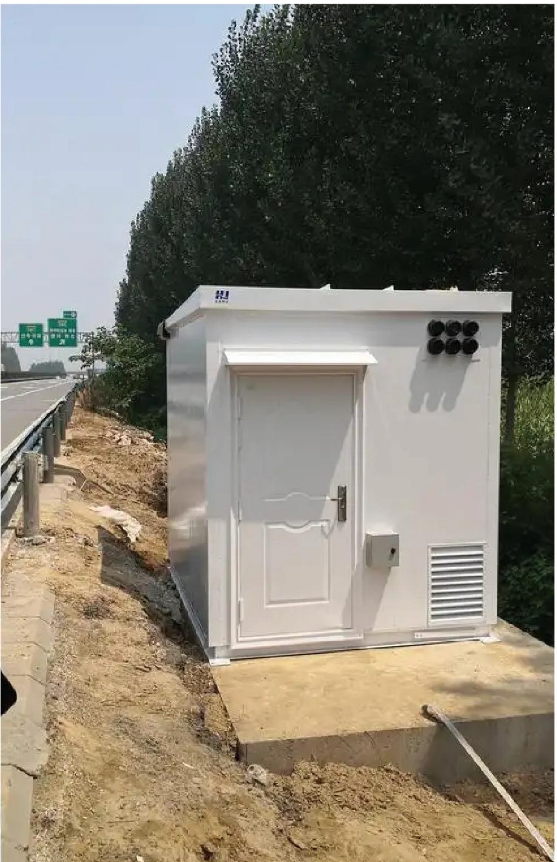
河南ETC门架系统一体化机房
