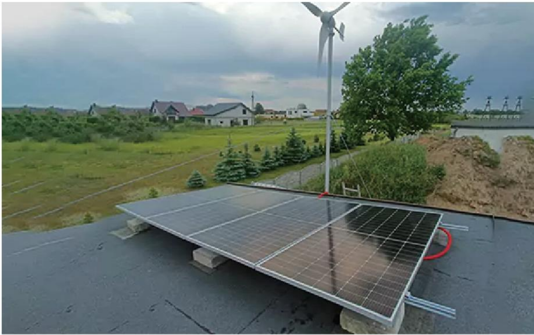
波兰 3kW/5kWh 风光储能项目
