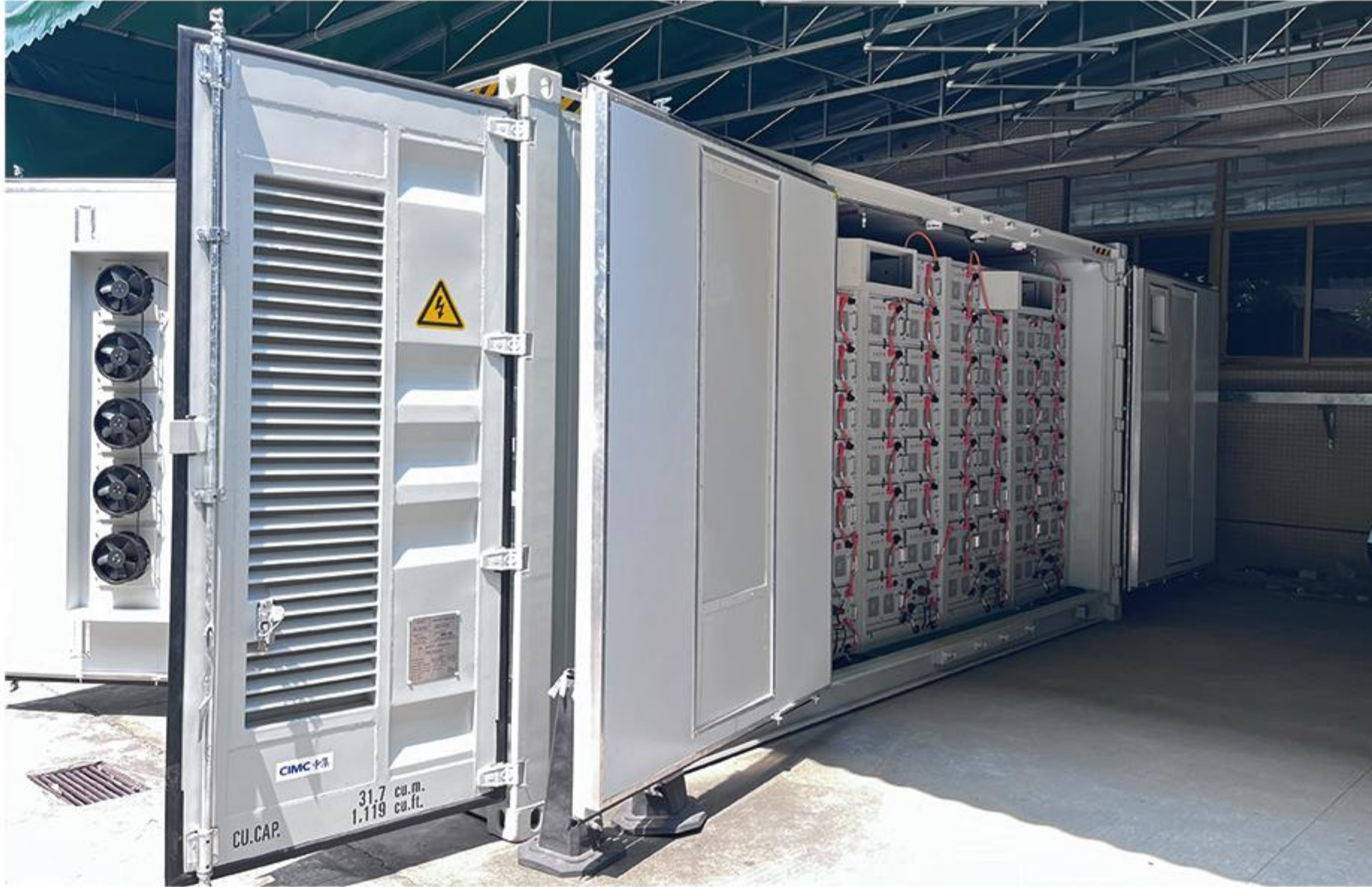
北欧100MWh集装箱储能系统
