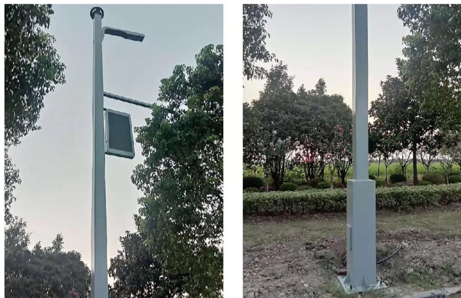
上海奉贤区奉城工业园多功能路灯应用
