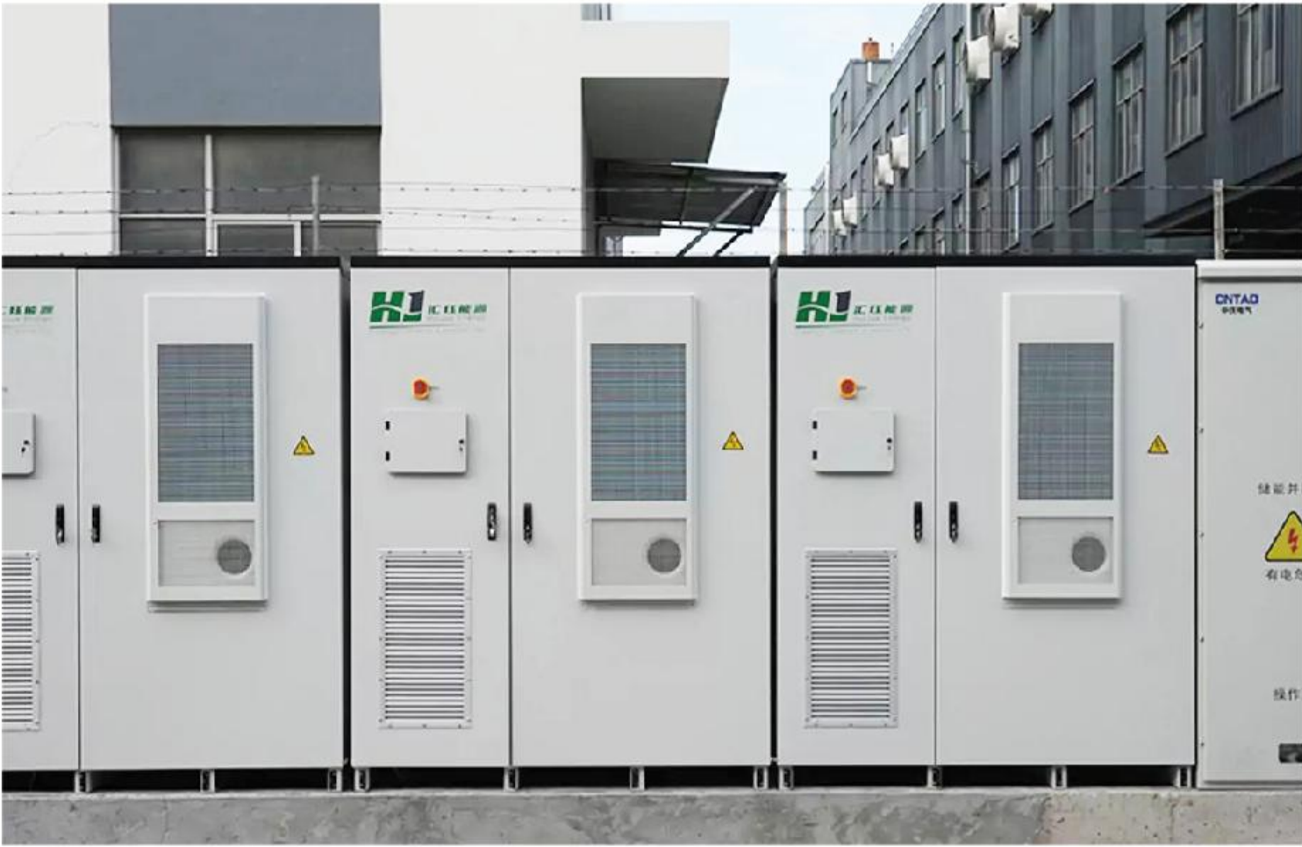
浙江台州 2795kWh 储能柜项目
