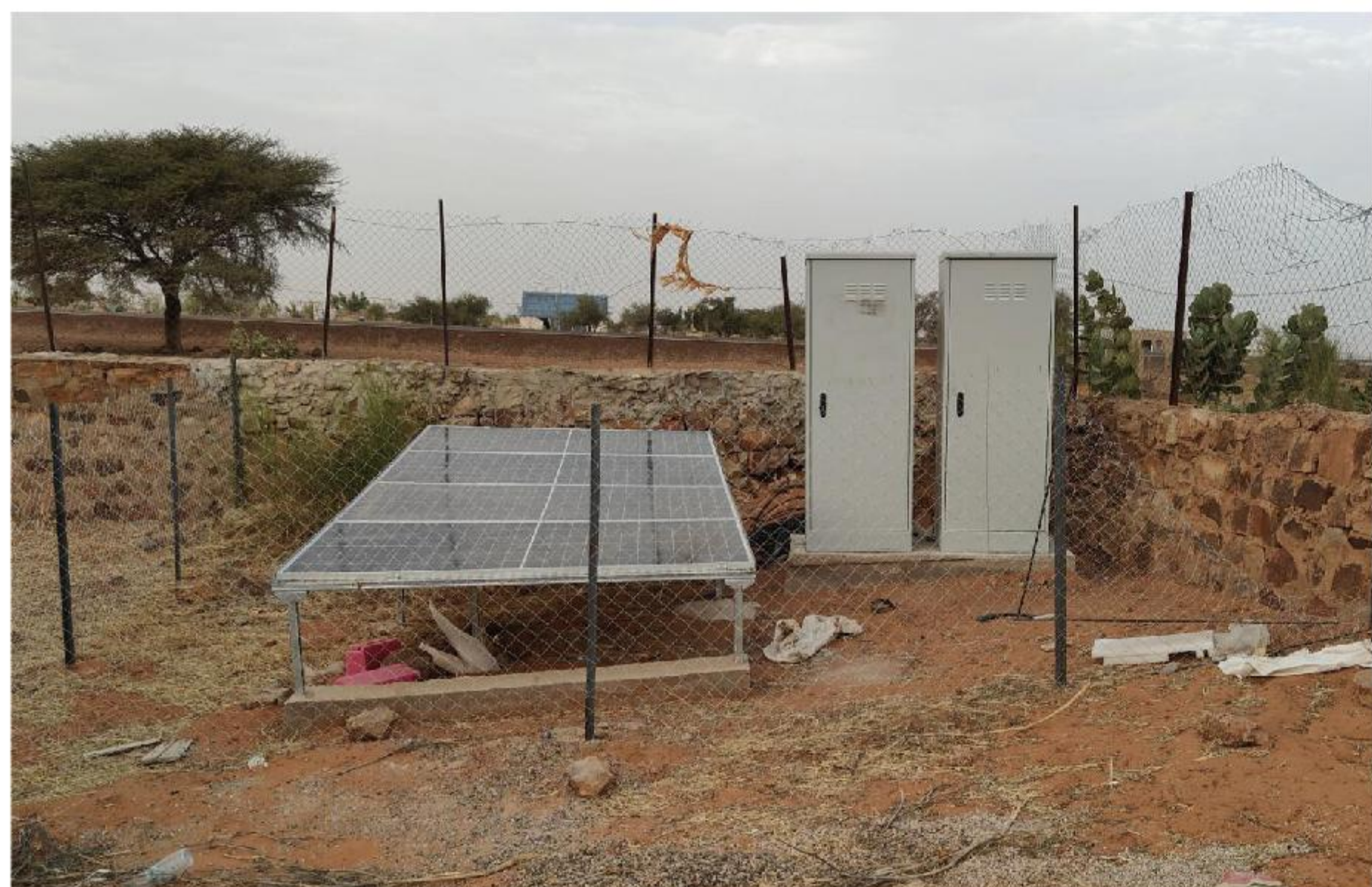
毛里塔尼亚 室外通信站点能源机柜
