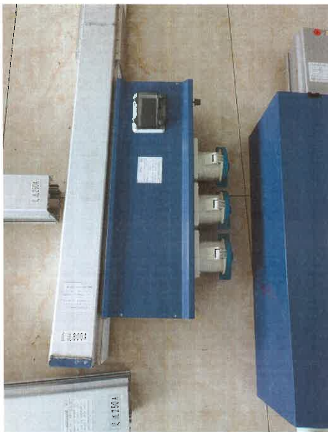
图1 数据机房末端母线槽（插接箱）
