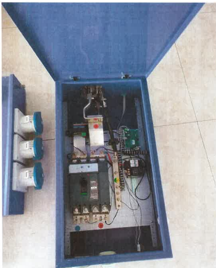
图2 数据机房末端母线槽（始端箱）
